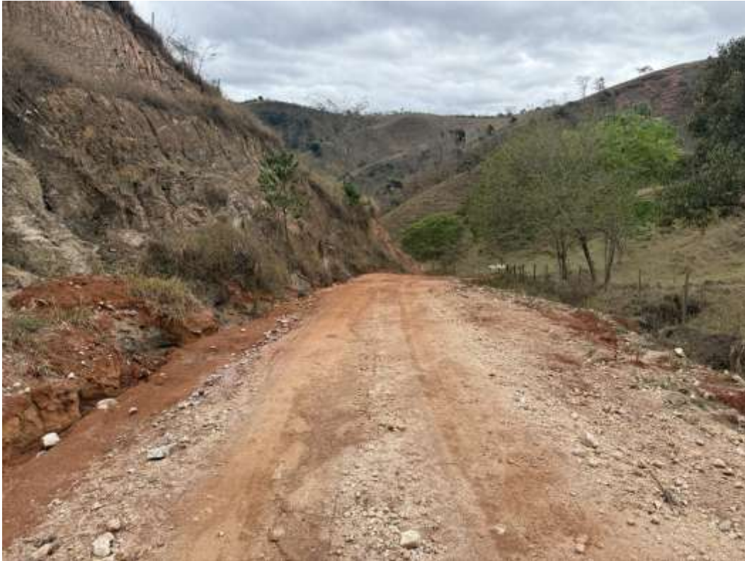
Figura 7 – Registro do trecho evidenciando irregularidades do leito carroçável, processos erosivos e ausência de dispositivos de drenagem adequados.
