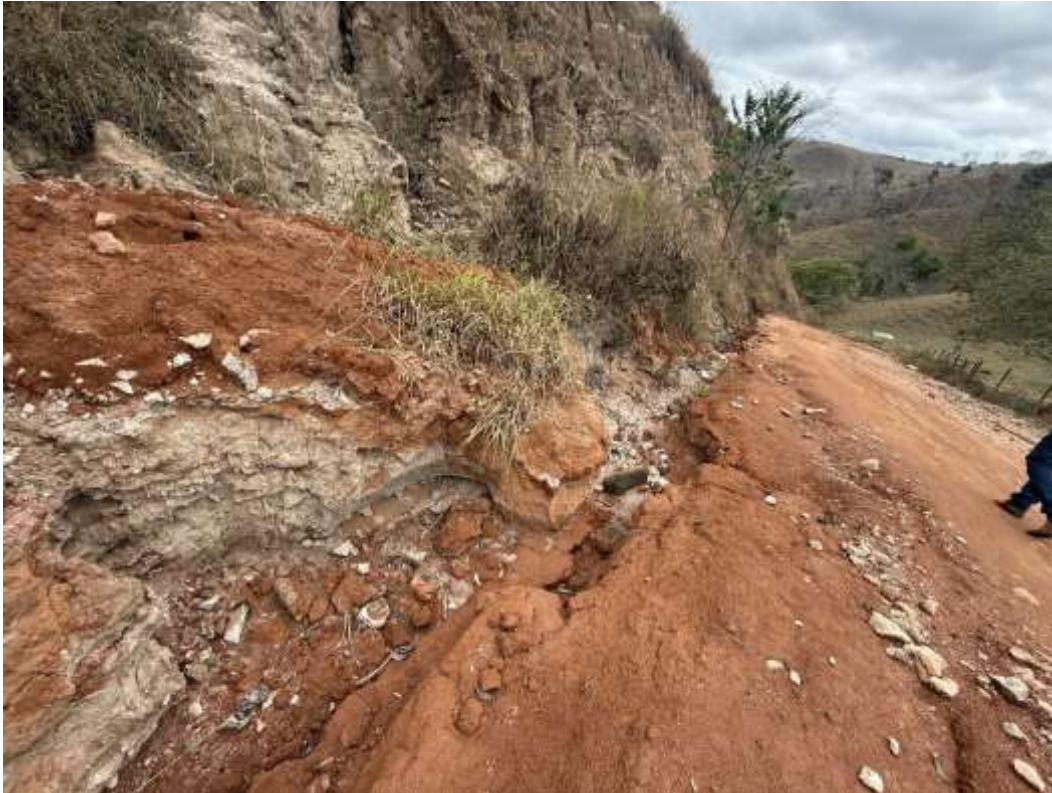
Figura 6 – Registro do trecho evidenciando irregularidades do leito carroçável, processos erosivos e ausência de dispositivos de drenagem adequados.
