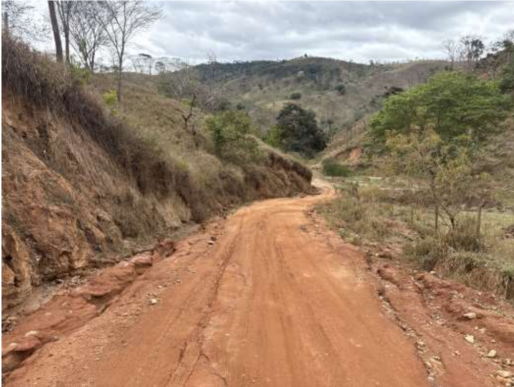
Figura 2 – Registro do trecho evidenciando irregularidades do leito carroçável, processos erosivos e ausência de dispositivos de drenagem adequados.
