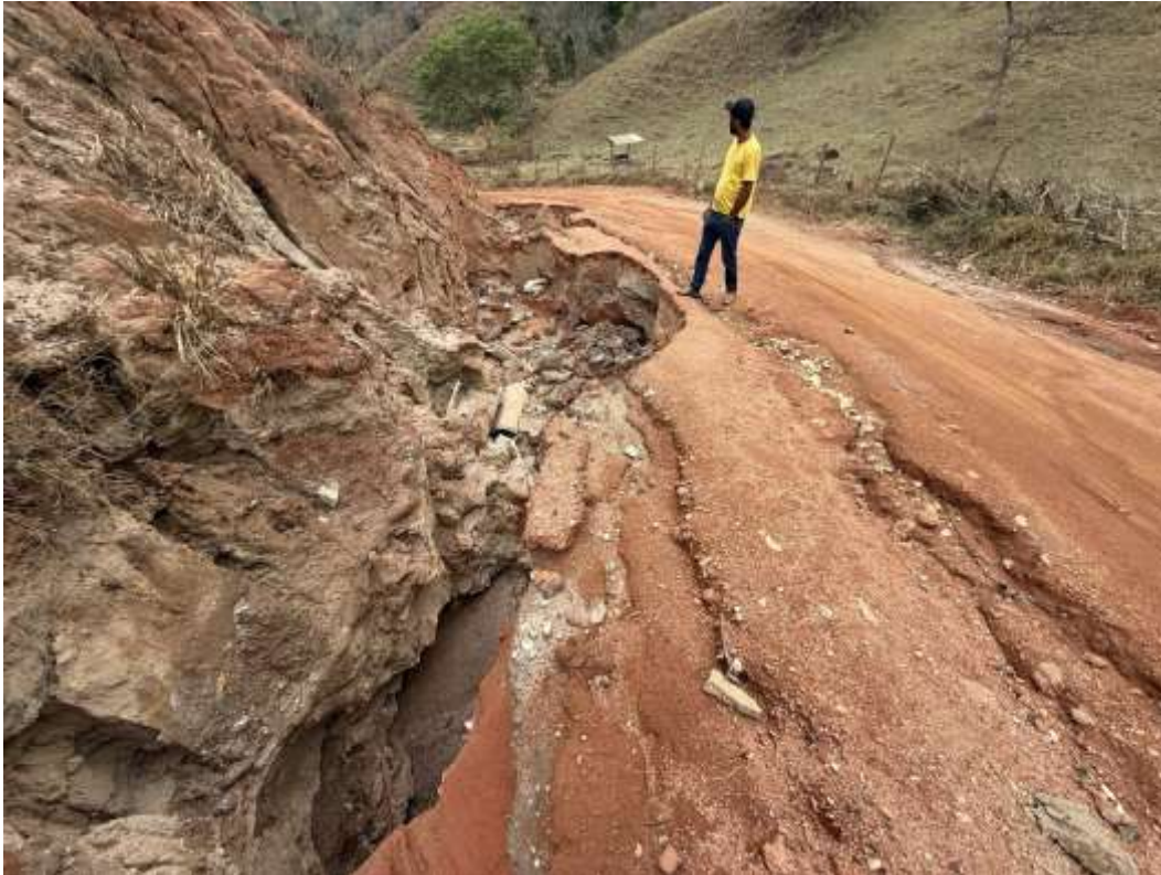
Figura 5 – Registro do trecho evidenciando irregularidades do leito carroçável, processos erosivos e ausência de dispositivos de drenagem adequados.
