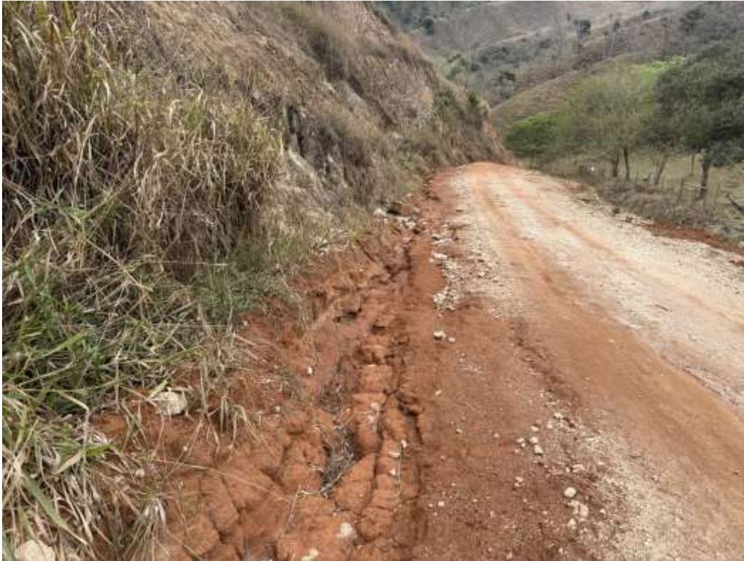
Figura 3 – Registro do trecho evidenciando irregularidades do leito carroçável, processos erosivos e ausência de dispositivos de drenagem adequados.
