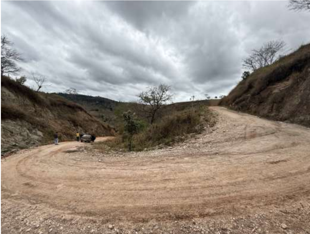
Figura 8 – Registro do trecho evidenciando irregularidades do leito carroçável, processos erosivos e ausência de dispositivos de drenagem adequados.
