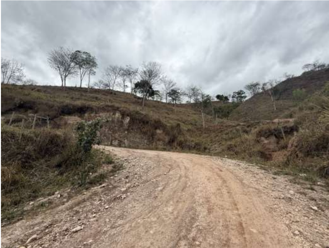
Figura 9 – Registro do trecho evidenciando irregularidades do leito carroçável, processos erosivos e ausência de dispositivos de drenagem adequados.
