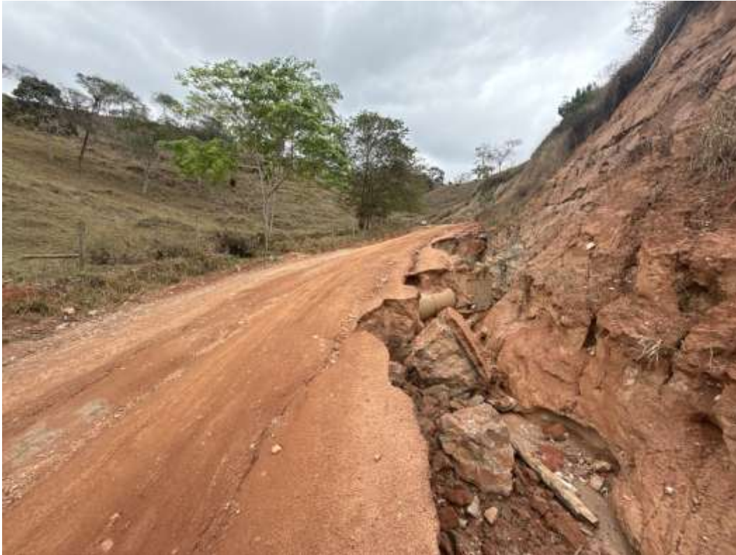
Figura 4 – Registro do trecho evidenciando irregularidades do leito carroçável, processos erosivos e ausência de dispositivos de drenagem adequados.
