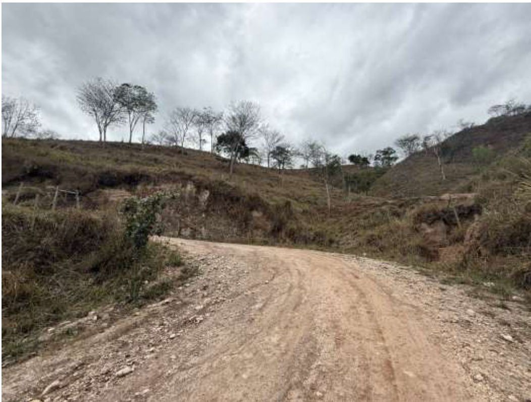
Figura 1 – Registro do trecho evidenciando irregularidades do leito carroçável, processos erosivos e ausência de dispositivos de drenagem adequados.
