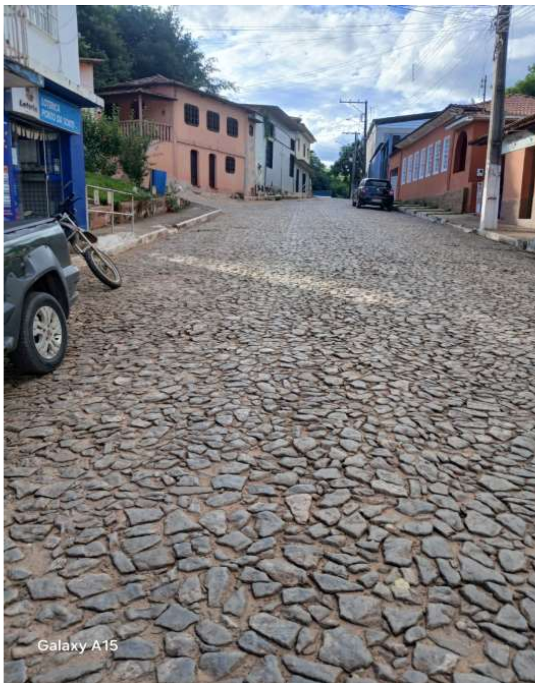
Foto 01 – Vista geral da via com pavimento poliédrico apresentando irregularidades superficiais e desgaste.
