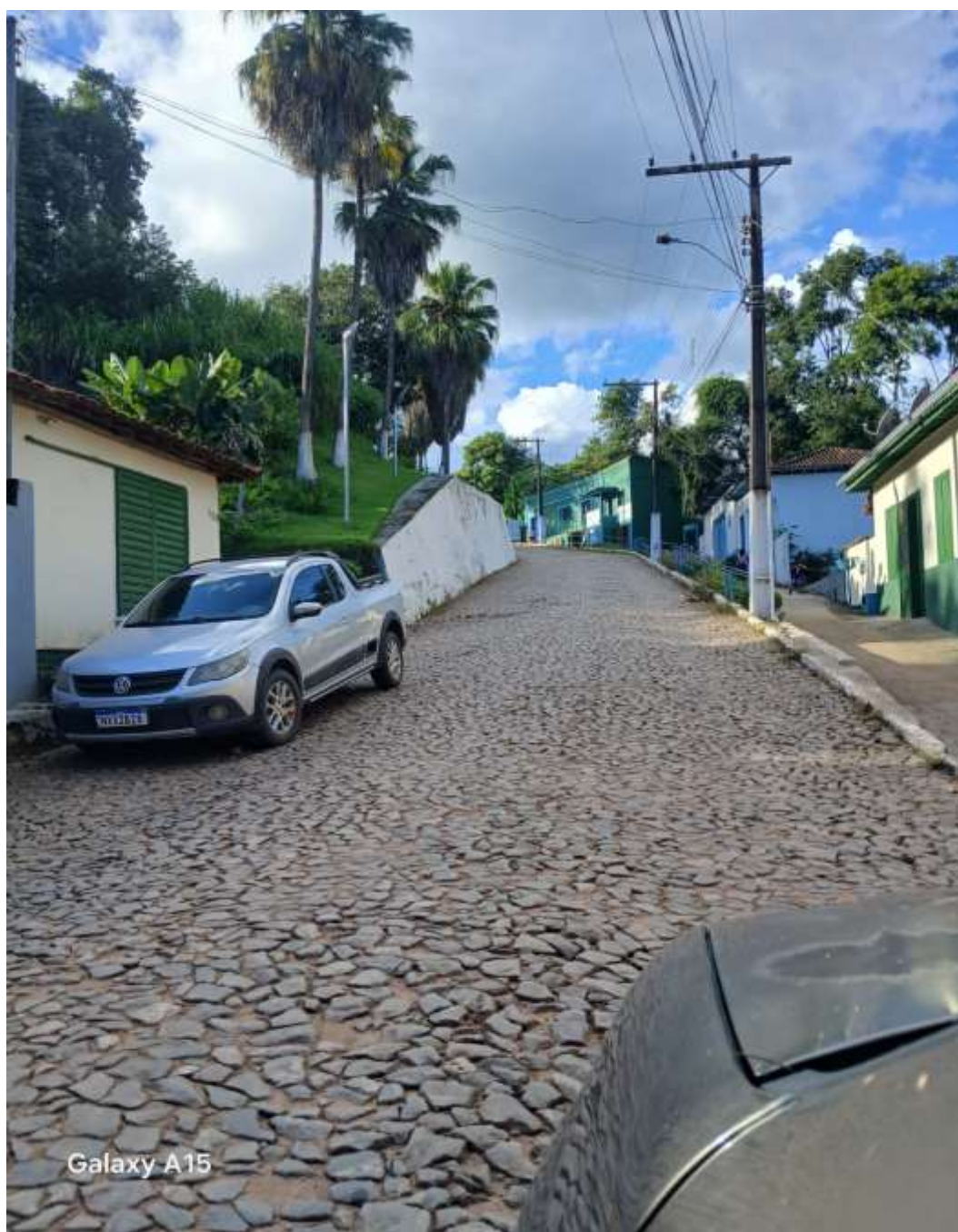
Foto 02 – Trecho em declividade acentuada com desgaste e perda de rejuntamento.
