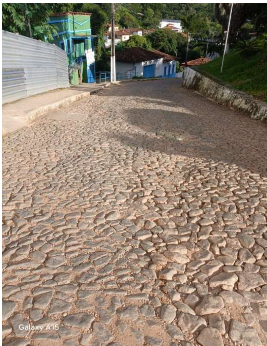
Foto 04 – Irregularidades superficiais e possíveis recalques localizados.
