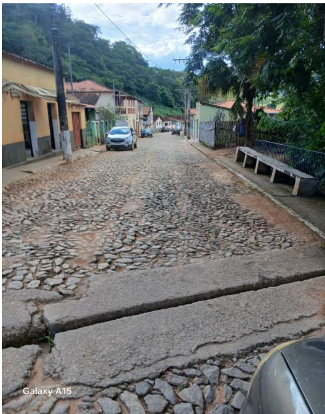
Foto 05 – Trecho com deficiência de drenagem superficial e acúmulo de material.
