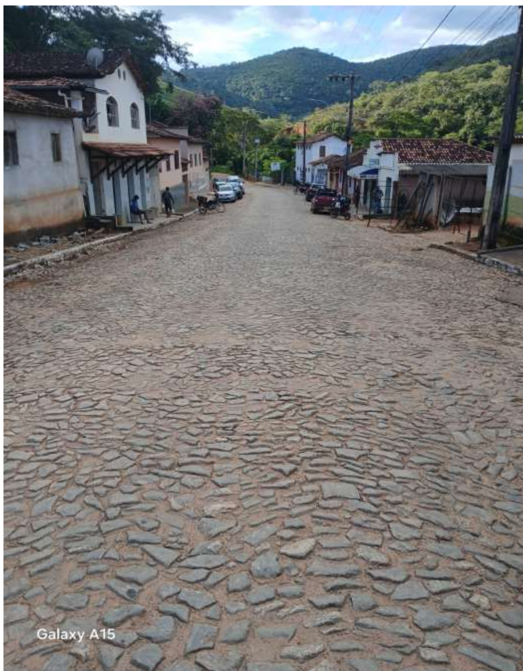
Foto 06 – Vista geral complementar evidenciando desgaste ao longo da via.
