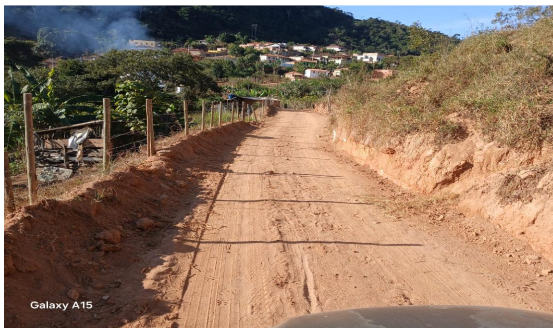
Trecho em solo natural sujeito à erosão e formação de sulcos em períodos chuvosos.
