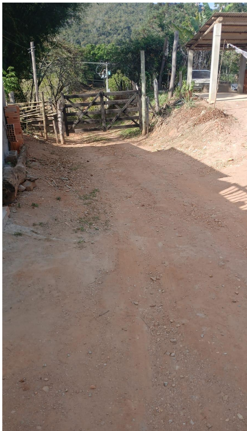
Foto 04 – Vista aproximada do trecho junto ao portão de acesso, evidenciando a condição atual do leito e das margens da via.
